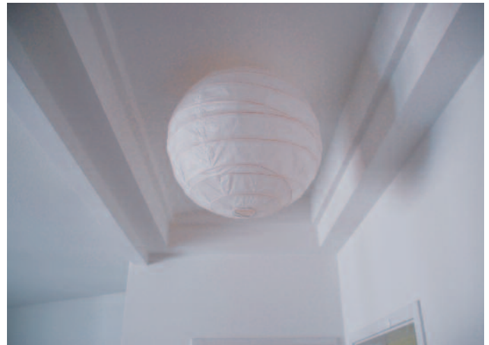
Unter diesen speziell für die WBG Fürth angefertigten Gipskartonverkleidungen „verstecken“ sich die Refresh-Zu- und Abluftkanäle.
