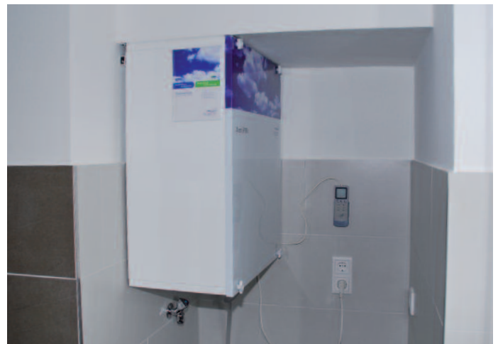
Herzstück des Refresh-Systems ist der Wärmetauscher im Inneren des Lüftungsgeräts, das in dieser Wohnung im Bad angebracht ist.
