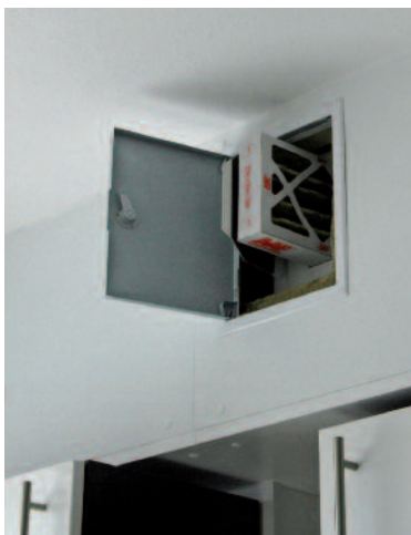
Die Wartungsklappen ermöglichen eine schnelle und unkomplizierte Filterreinigung durch den Mieter.
