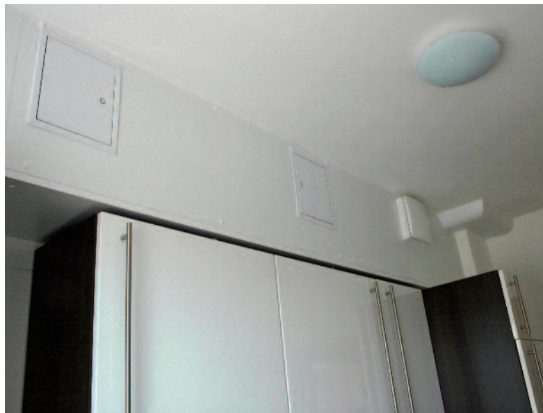
Das Avent R100 wurde in der Küche über den Hängeschränken praktisch unsichtbar. Die flexiblen Plugg-Flex Kanäle passen sich allen Gegebenheiten an, selbst kleine Ecken, wie hier der Schornstein, sind kein Hindernis.
