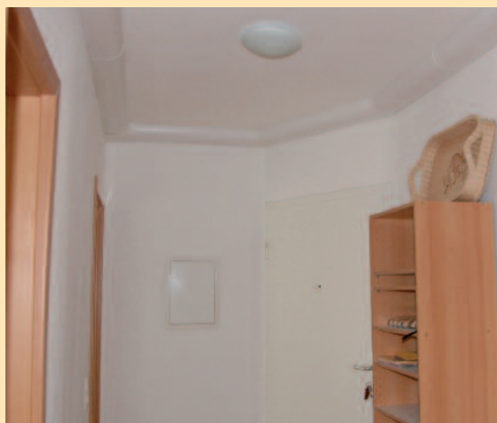
Die Kanäle des refresh Verteilsystems verlaufen im Flur ringförmig und bieten so eine optimale Luftverteilung.
