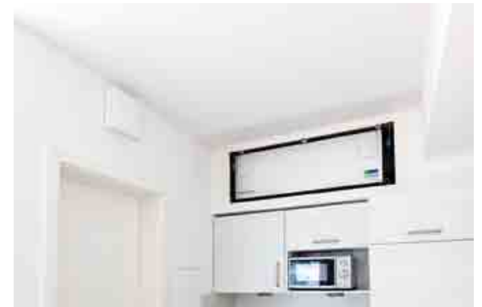
Lüftungsgerät hinter Abkofferung
