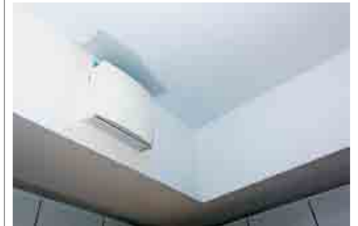
Raum mit Zuluft- und Abluftauslass
