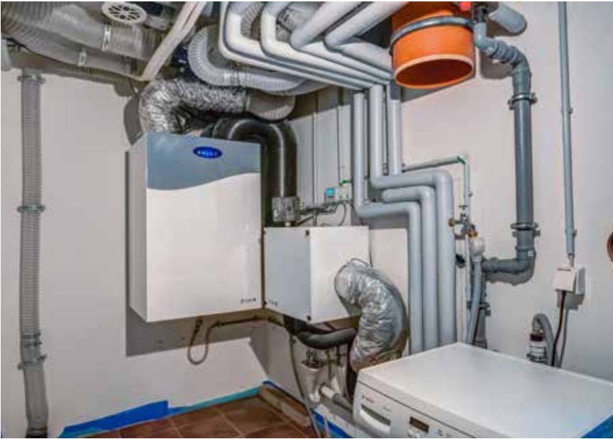
Die Pluggit-Lüftungsanlage mit Lüftungsgerät AP310 im Hauswirtschaftsraum.
