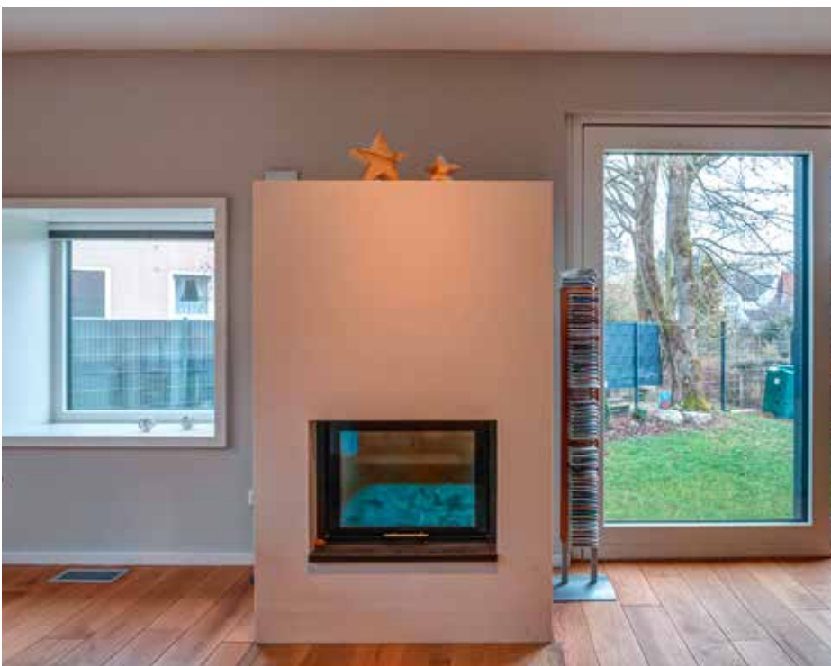
In der ersten Heizsaison lief der wasserführende Scheitholzkamin noch regelmäßig, da das Haus austrocknen musste. Ganz unauffällig links daneben: Der Auslass, aus dem die frische Luft langsam nach oben quillt.
