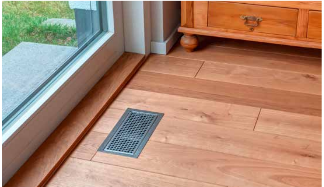
Auslassgitter für die frische Luft im Boden des Wohnzimmers.
