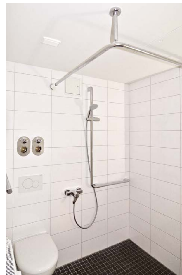
PluggPlan Abluftaustlass in Deckenmontage im Badezimmer.
