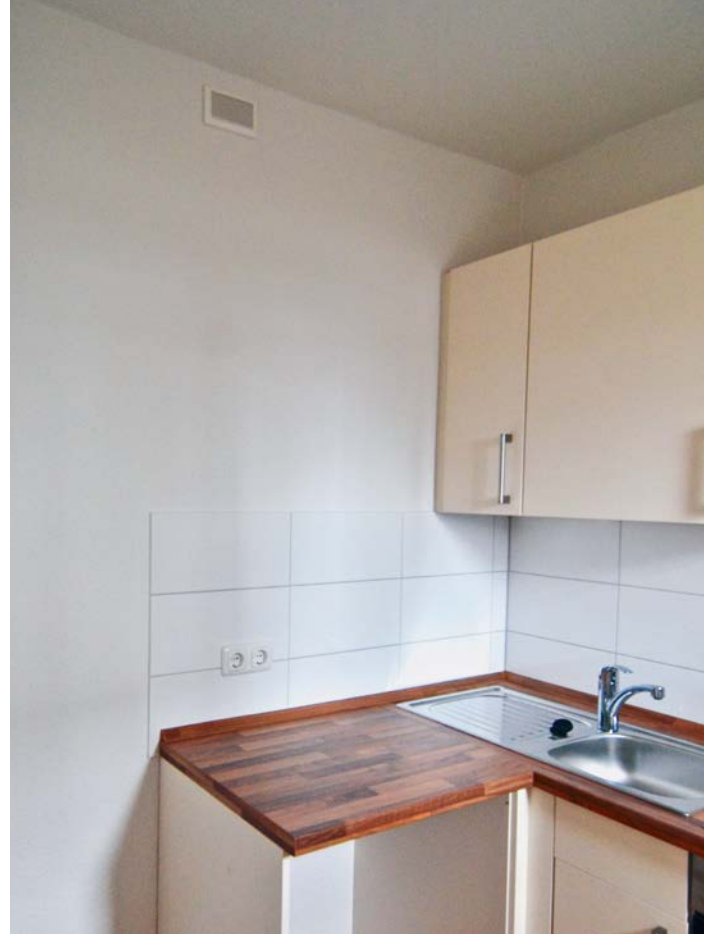
Unauffällig integriert: der PluggPlan Abluft-einlass unter der Decke in der Küche.
