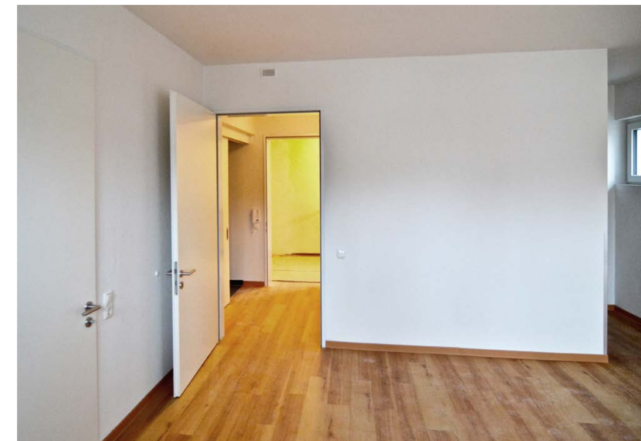
Dezent und unauffällig: der PluggPlan Zulufteinlass über der Zimmertür des Wohnraums.
